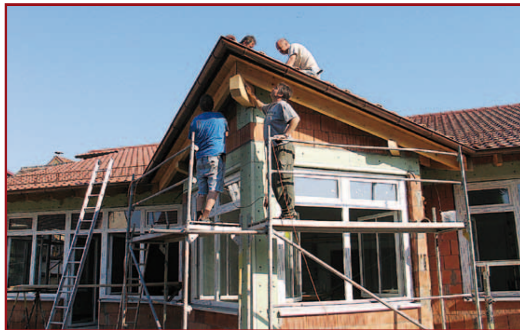
Das Dach wird eingedeckt. Jetzt kann mit dem Innenausbau des Kindergartens begonnen werden. FOTO: ORTH
